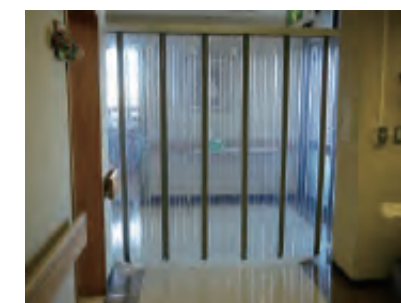
愛知県 病院通路 一般防災静電リブ
